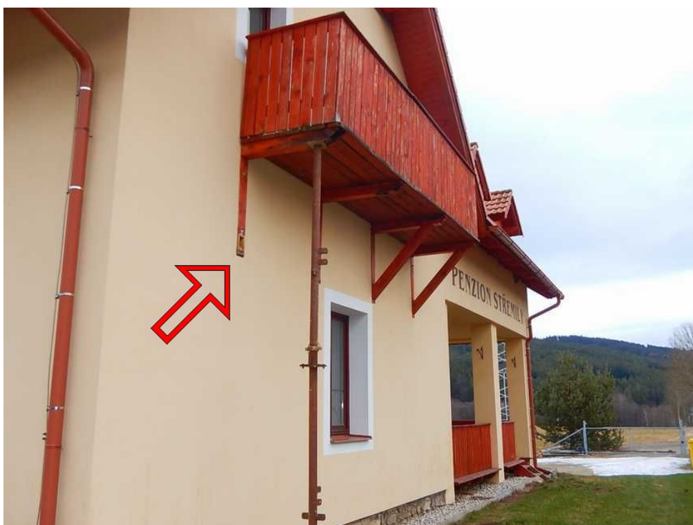
balkon s provizorním podepřením
